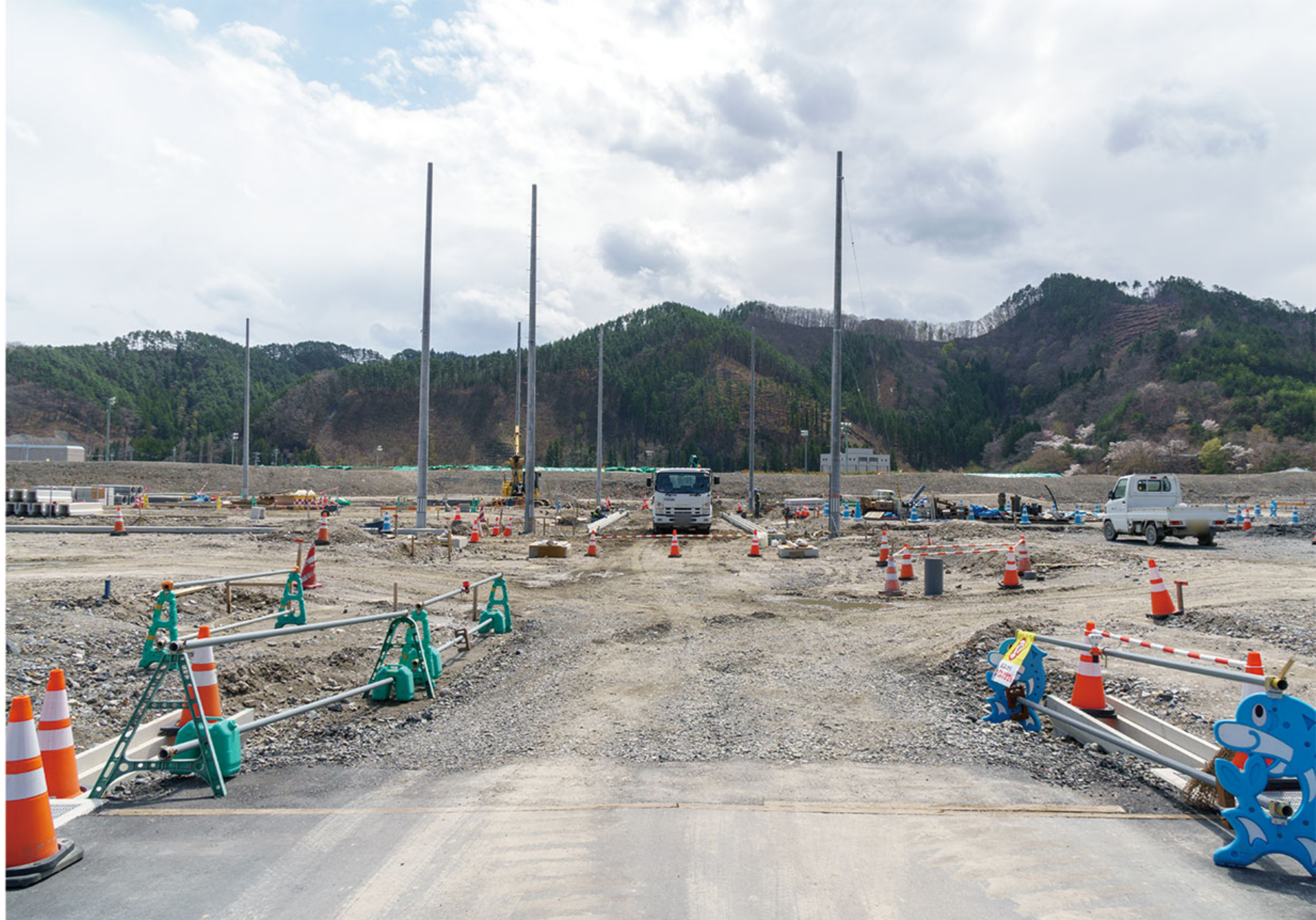
4月19日：県道から1ブロック南側の街区（南北方向）の様子。街区全体をU字溝で囲ってしまうと作業車両が出入りできなくなってしまうため、一部出入りを確保した状態で宅盤の整備を行い、一通り終わったタイミングでU字溝を設置している。敷設した上に通路を確保する手法もある。 ※この写真集で単に「県道」と示した場合は県道280号（旧国道45号）を刺す
