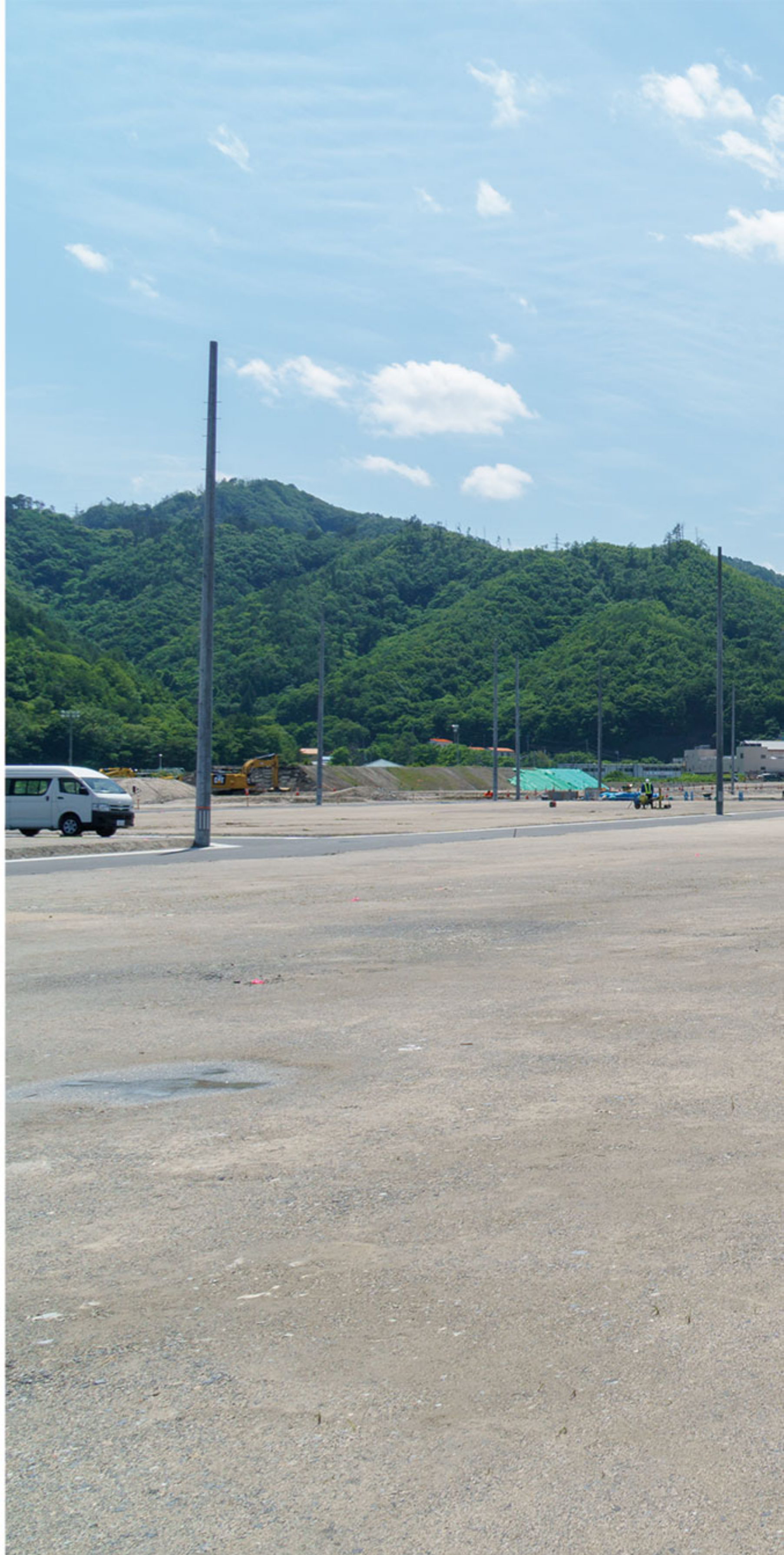
6月22日：宅地整備がほぼ終わり、杭の埋標や電線の架設を待つばかりとなった。写真右側の囲いは測量用の基準点を保護するためのもの。測量が終わると撤去される。
