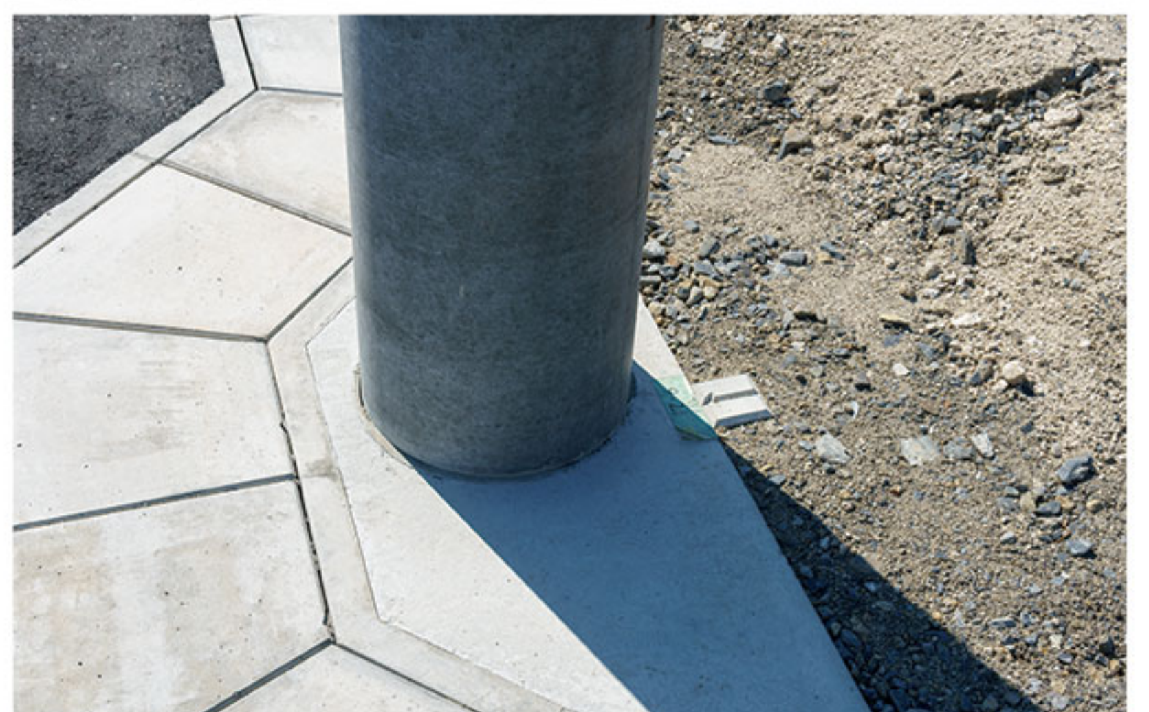
4月6日：電柱は宅地と宅地の境目に設置するのが基本となっている。
