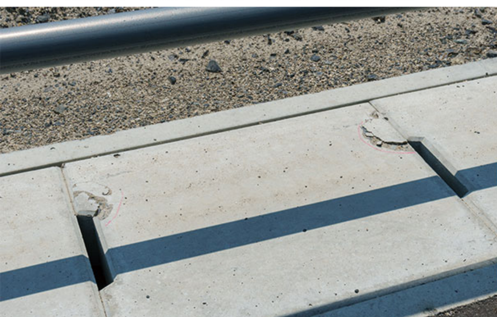
7月21日：破損が確認されたU字溝の蓋。破損部分に赤色で目印が書かれている。宅地引き渡し前に交換される。
