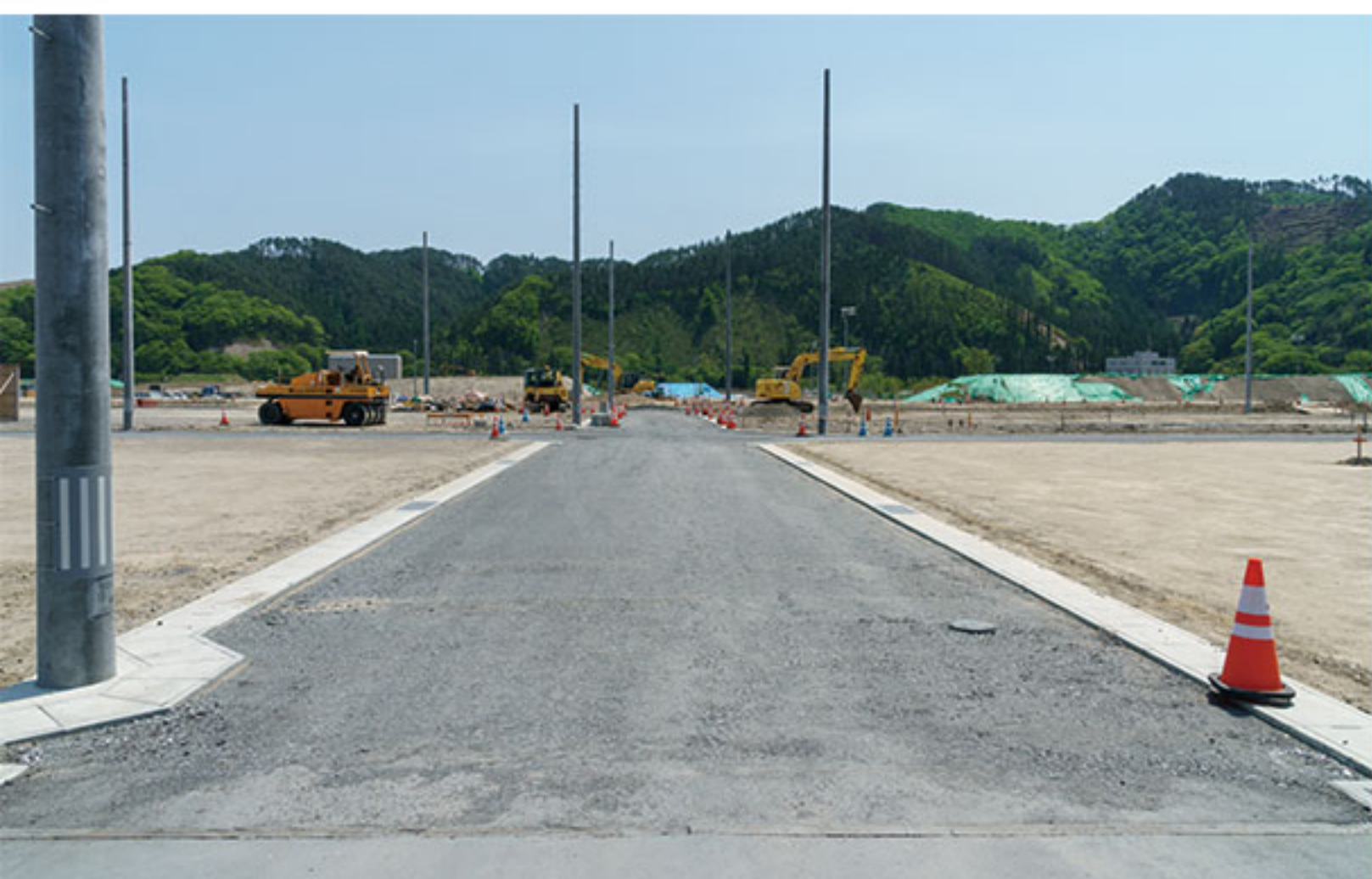
5月20日：南北方向の道路。基層の準備が終わり、表層（アスファルト）の舗装を待つだけとなった。
