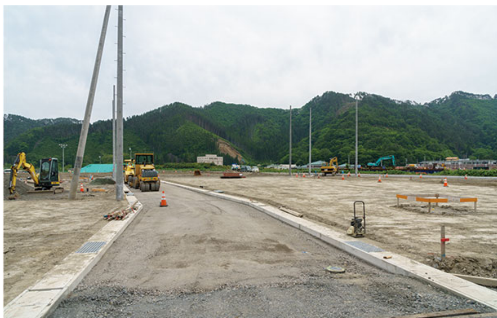
6月7日：表層（アスファルト）の下にある基層の整備を行っている。
