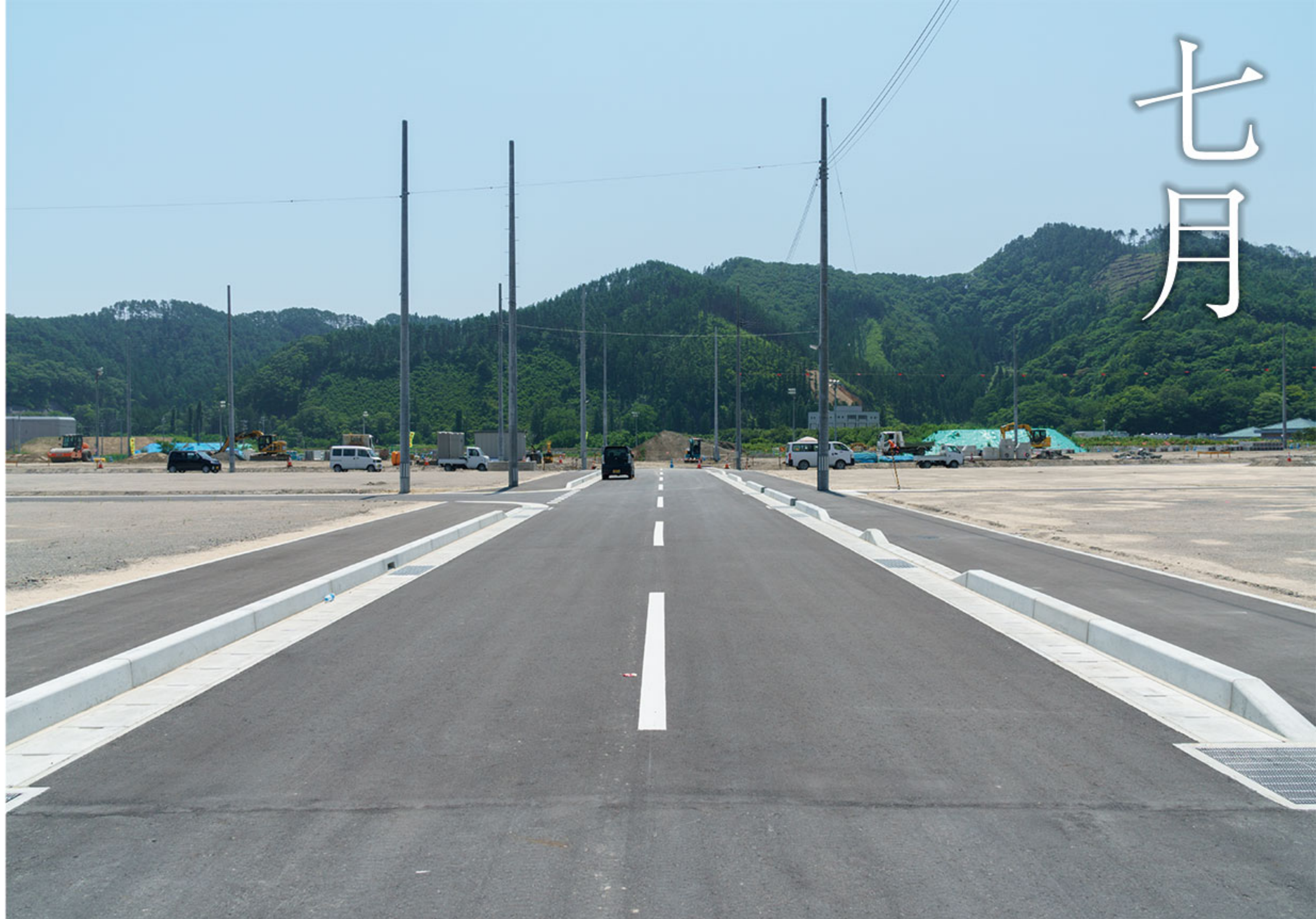
7月21日：歩道付きの少し広めの道路。小鎚神社の南側の道路である。道路の左右にある街区は両方とも7月31日に引き渡しが行われる。
