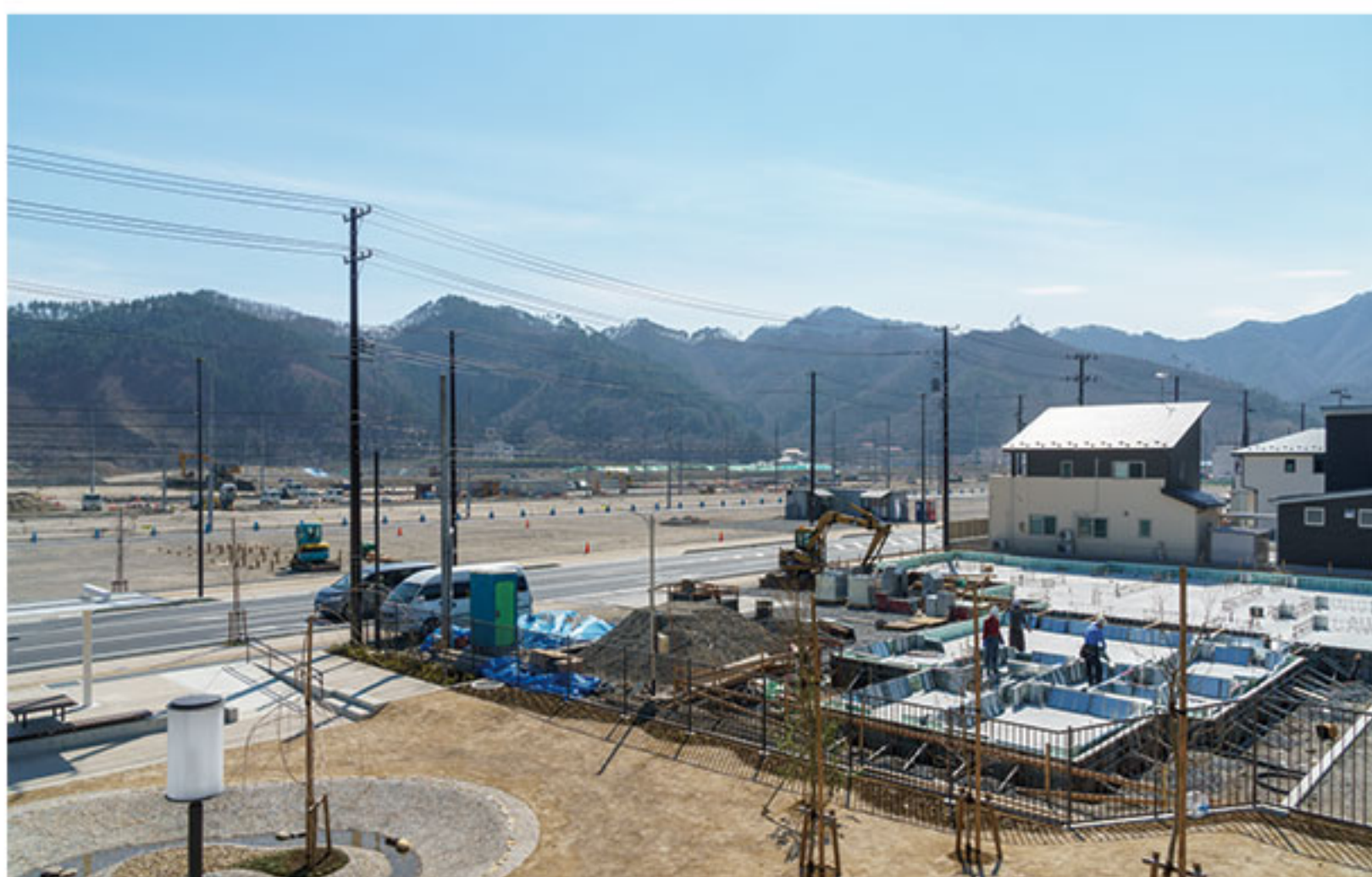
4月6日：代官所跡公園の隣の宅地では基礎工事が行われている。
