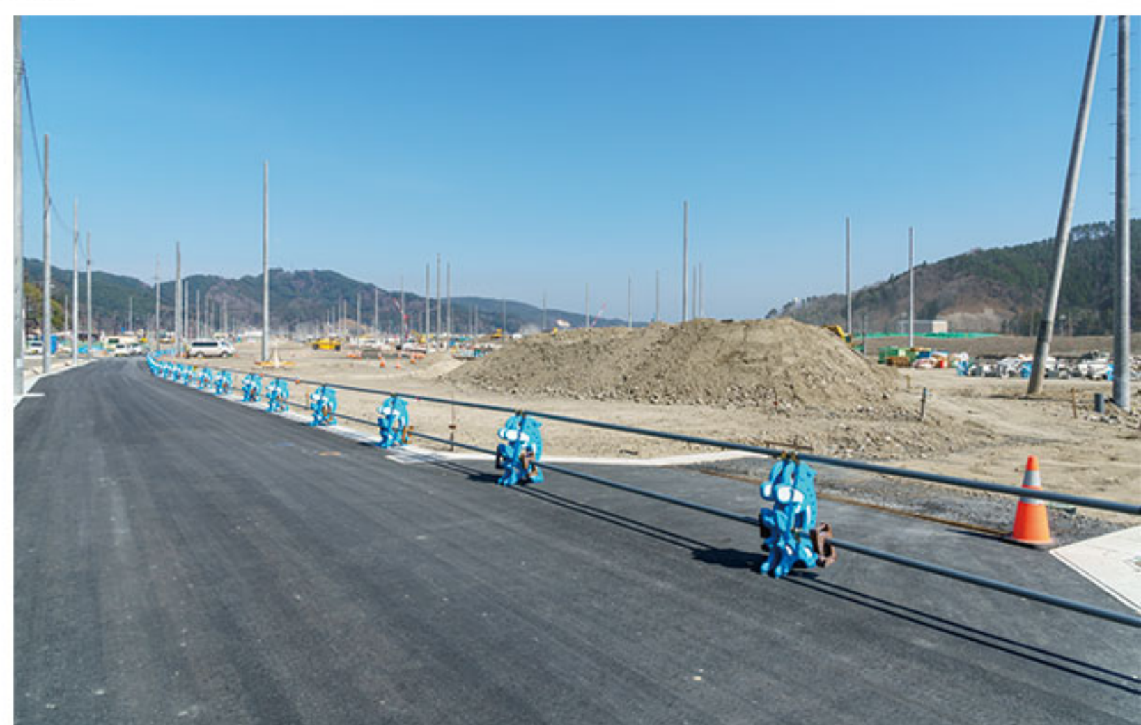
4月6日：県道から1ブロック南側の街区（東西方向）の様子。目標の高さまで土をすき取っている。すき取った土が積み上げられている。
