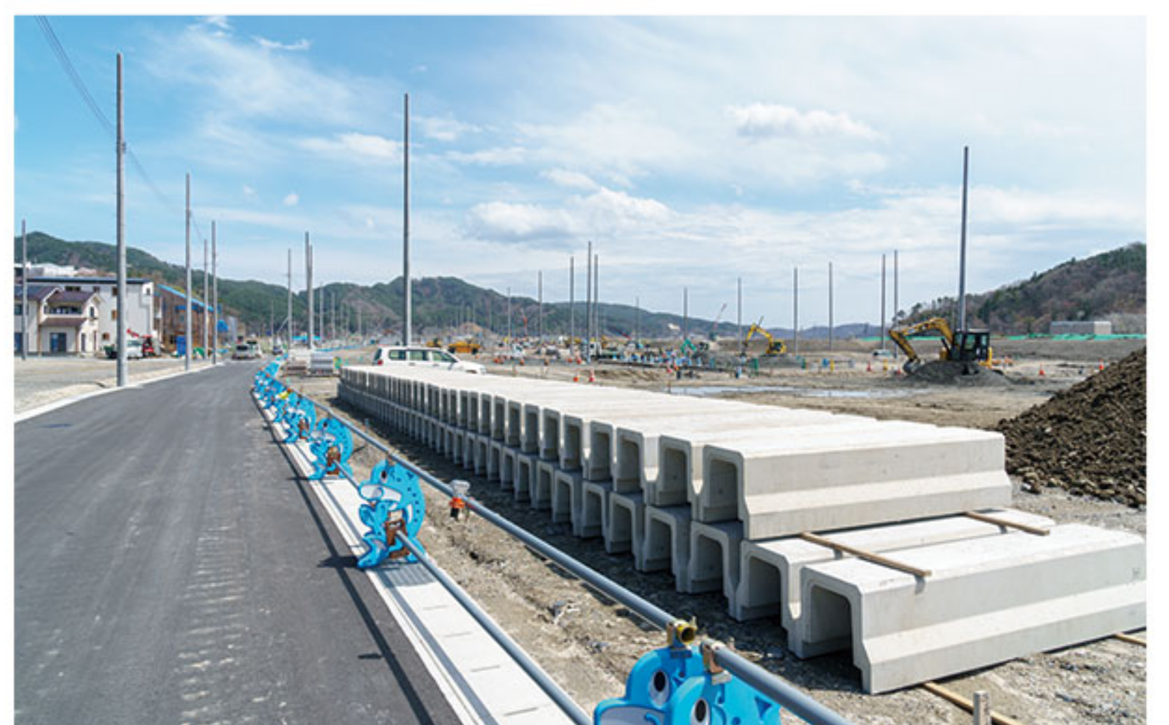
4月19日：U字側溝が積み重ねられている。手前の道路には既に敷設されているため、別の場所で使うと思われる。
